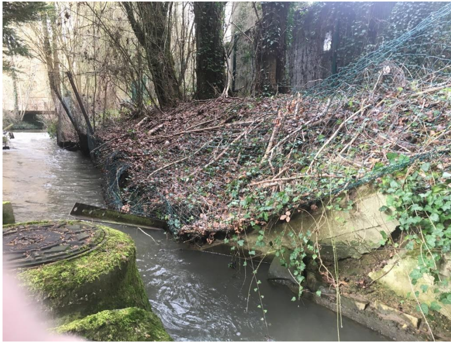
Effondrement berge gauche (Zone 1 Photo1)
