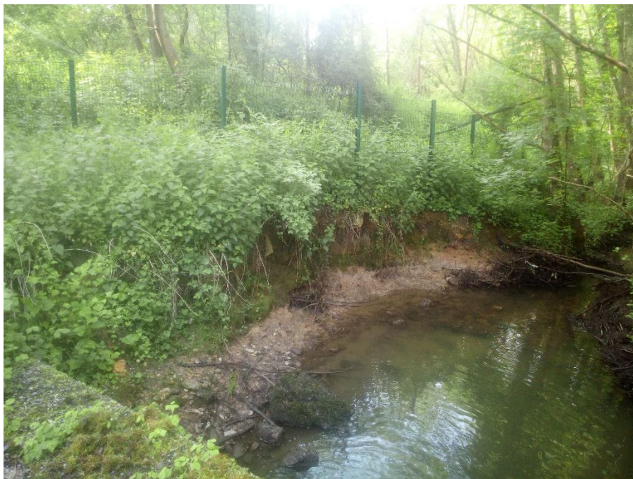
Encoche d'érosion (Zone 3 photo 3)
